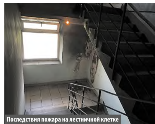
Последствия пожара на лестничной клетке
