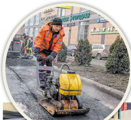
В асфальте появились трещины после зимы
